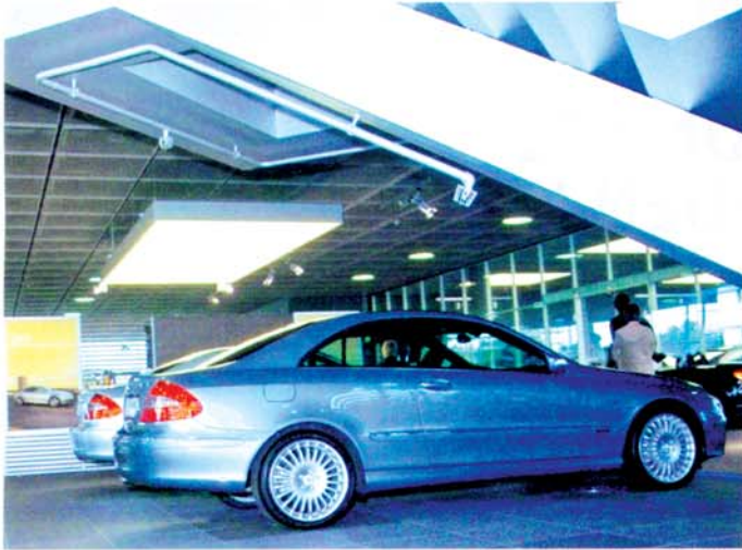
Zwei Sprinkler sind direkt über einzelnen, sehr teuren Automobilen installiert
