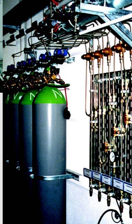
ARGONITE®-Zentrale bei IONITY, Kamenz
