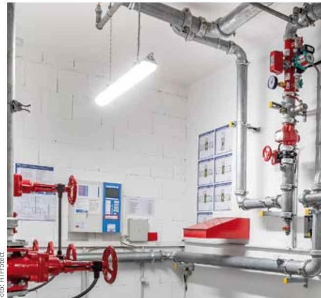
Sprinklerzentrale mit automatisch ansteuerbaren Strömungsmelder
